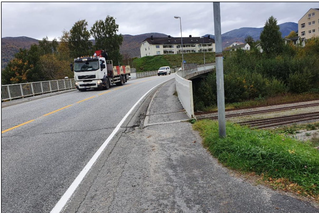
Figur 20 Vangsbrua har smalt fortau over brua med behov for utvidelse (foto: Norconsult)
